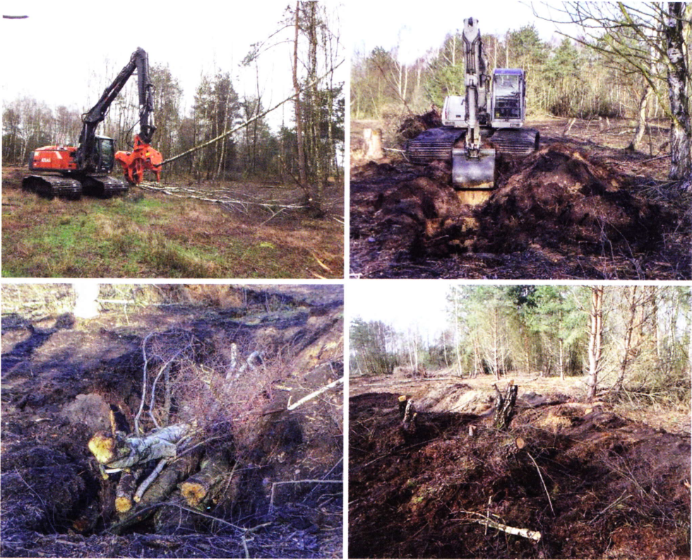
Abb. 6: Anlage eines Winterquartiers für Reptilien. Ein Bagger mit einem Fällgreifer am Ausleger kneift die Bäume am vorgesehenen Standort und hebt später eine Mulde aus (oben) die zunächst mit den vorher abgekniffenen Baumstämmen gefüllt, dann mit einem Teil des gewonnenen Bodens wiederbefüllt und abschließend mit den ausgebaggerten Wurzelstubben der abgekniffenen Bäume abgedeckt wird (unten). Die Reste des ausgehobenen Torf- und Sandbodens werden als Windschutz und Eiablageplatz für Zauneidechsen am Rand liegen gelassen (d, rechte Seite und hinten). Fotos: T. Brandt.
