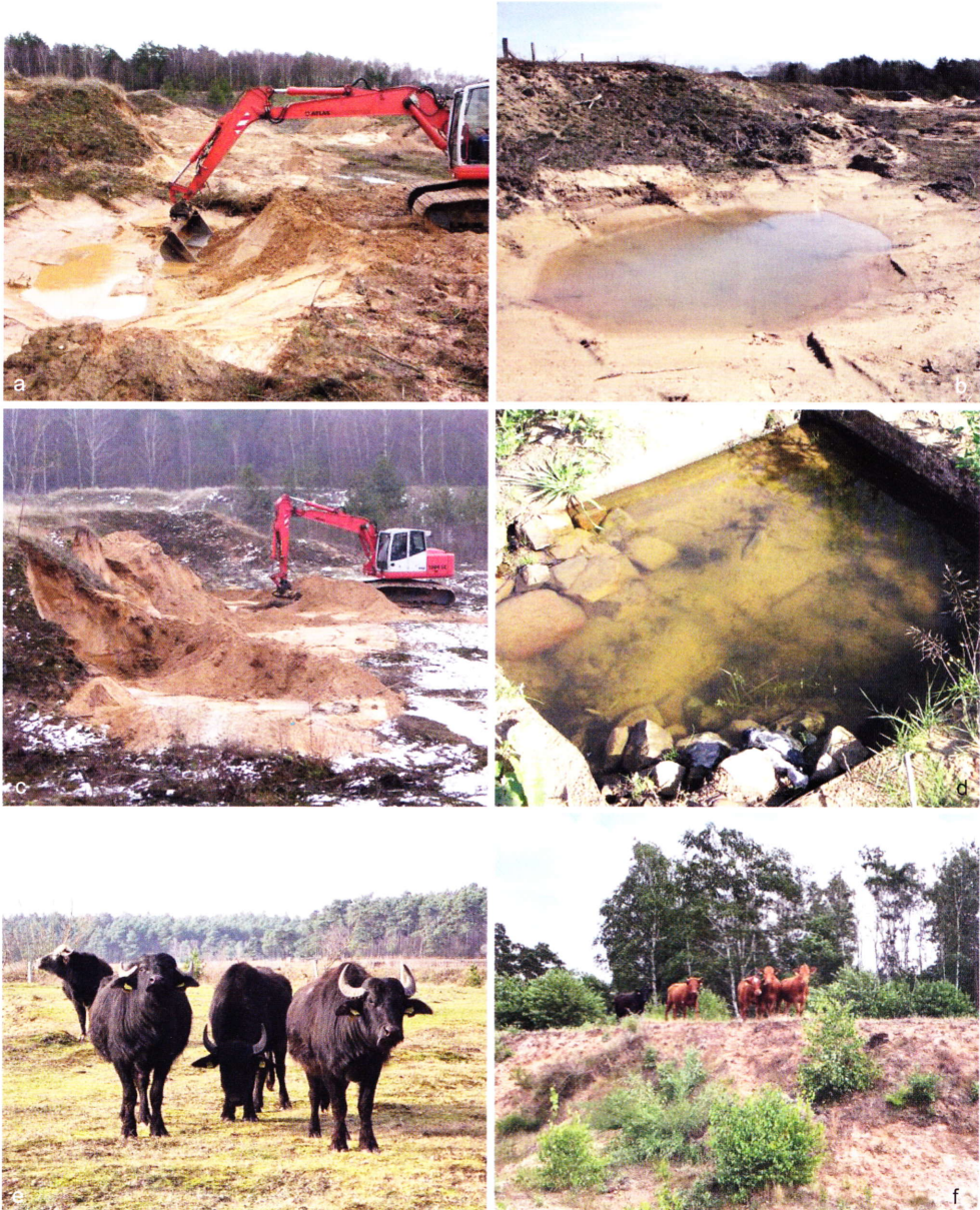
Abb. 4: Mit dem Bagger wurden in der Sandgrube Anfang 2013 zahlreiche Kleingewässer und Offenbodenstandorte (a, b), außerdem vereinzelt Steilwände geschaffen (c). Zur Sicherung des Kreuzkrötenbestandes wurden 2012 zwei künstliche Becken angelegt (d). Zur Offenhaltung der Fläche beweideten von 2012 bis 2021 fünf Wasserbüffel sowie 2023 und 2024 Hausrinder unterschiedlicher Rassen die Sandkuhle (Fotos: a–d: T. Brandt, e, f: E. Lüers).
