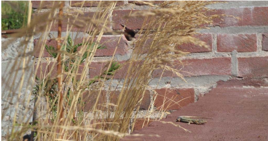
Zonnende muurbagedis bovenop de onderdoorgang Sillebergweg. Op de achtergrond is een aangepaste voeg met gat te zien welke voor de muurbagedis zijn aangebracht.
